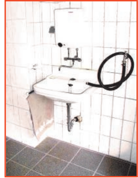
Abb. 11: Handwaschbecken mit warmem Wasser
