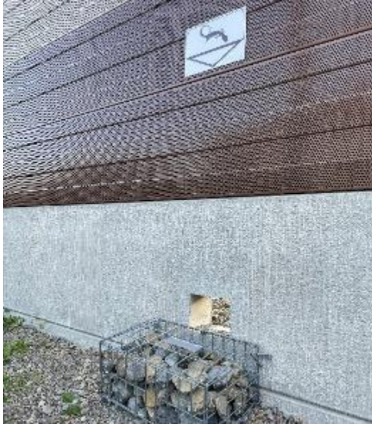
Bild 19: Funktionale Durchlässe bei der Deutschen Bahn: bei Lärmschutzbauten entsteht etwa alle 25 m eine Verbindung.
