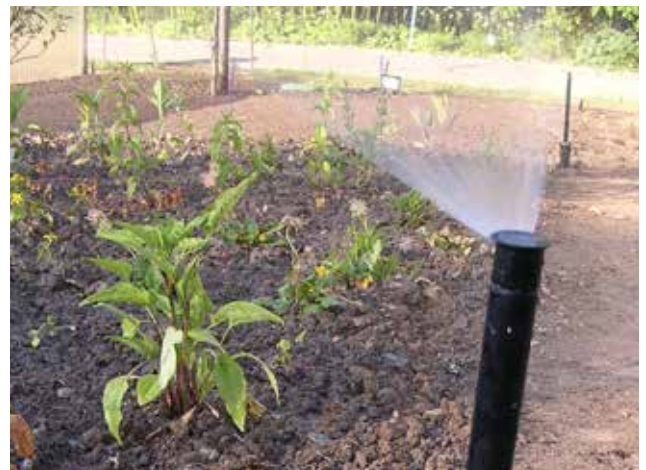
Sprühregner mit hohem Aufsteiger
