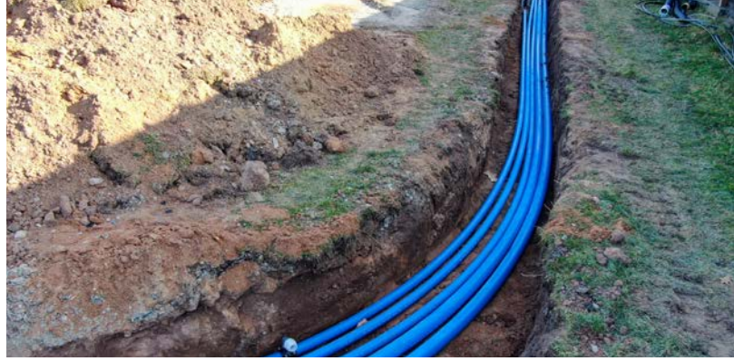
Leitungsverlauf aus dem Hauptverteilerschacht.
