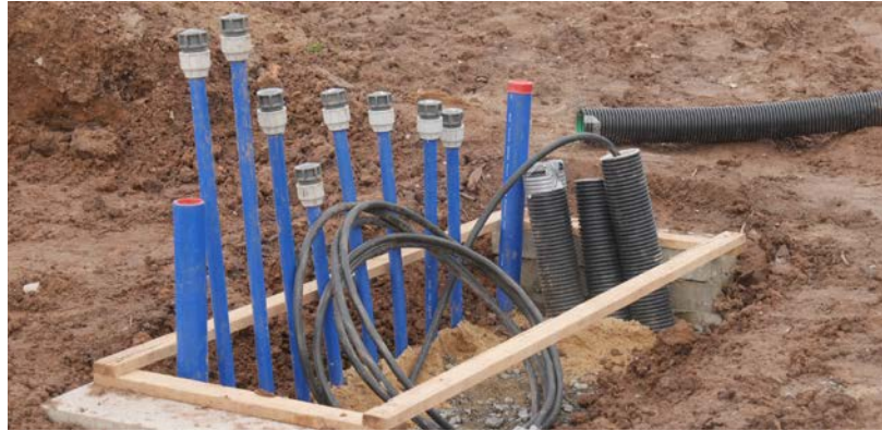
Die einzelnen Leitungen treffen sich in den Verteilerboxen (Rohzustand).
