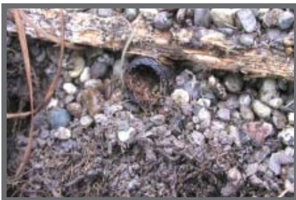
Bild 2: Querschnitt durch ein Verteilerrohr des Beschickungssystems. Das Rohr ist bereits zur Hälfte mit Wurzeln der Repositionspflanzen zugesetzt.
