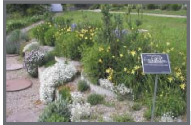
Bild 1: Aufgrund der ästhetisch sehr ansprechenden Bepflanzung lässt sich die Grauwasseranlage sehr gut in Grünflächen oder einen Hausgarten integrieren.
