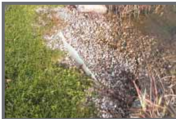
Bild 2: Eine Abtrennung des Regenerationsbereiches zum Umland mit einer hochgezogenen aber nicht befestigten Folie ist als mangelhaft einzustufen.
