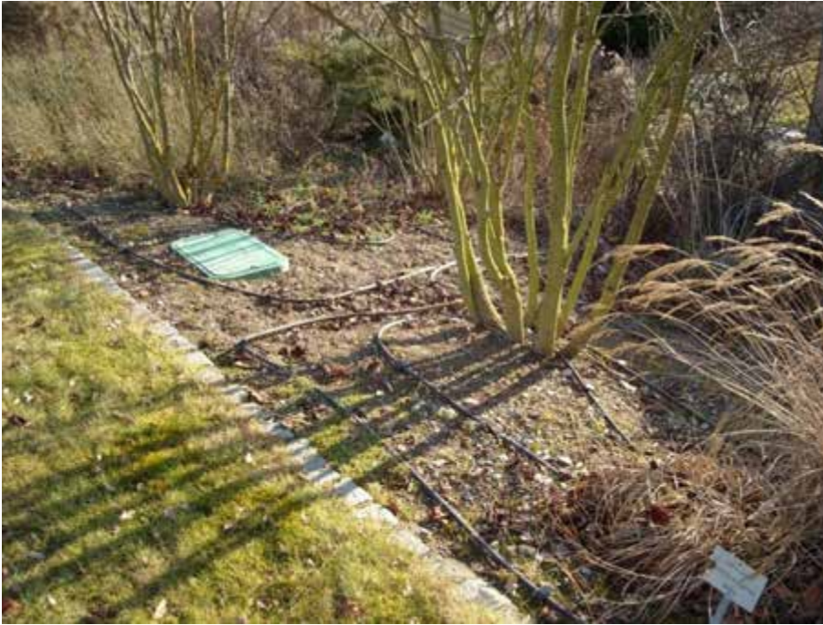
Abbildung 5: Ventilkasten und Tropfleitung der Firma Hunter am Technikzentrum (Parzelle 21)
