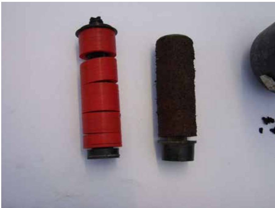
Abbildung 15: Verstopfte Scheibefilter durch das direkt aus dem Hochbehälter entnommene Wasser mit unzureichender Vorfiltration. Links der Scheibeneinsatz im gesäuberten Zustand.
