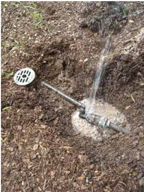
Abbildung 22: Aus Bequemlichkeit sollte eine spatentiefe Verlegung der Rohrleitung in Vegetationsflächen nicht unterbleiben.
