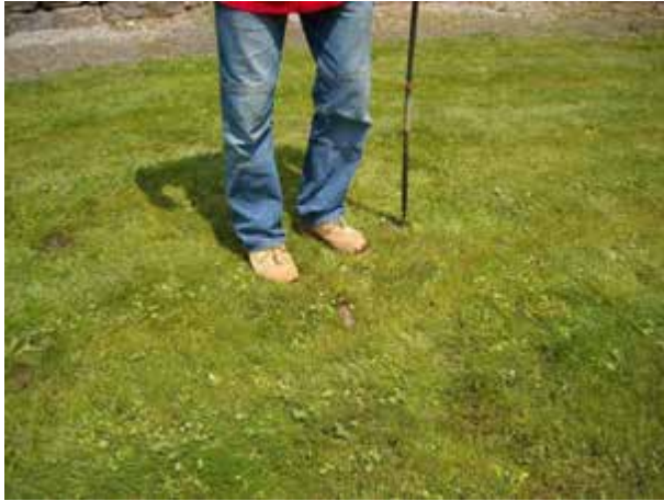
Abbildung 20: Undichte Rohrverbindung führte zunächst unbemerkt zu einer Wasserblase unter der Rasendecke (Parzelle 32).
