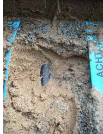
Abbildung 19: unsachgemäße Verlegung 4 cm unterhalb des Pflasters
