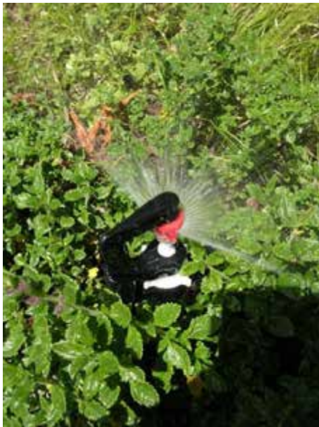
Abbildung 16: Mikrosprüher, die auf einem Stativ über die Bodendeckerpflanzung hinausragen, sind anfällig für Vandalismus.
