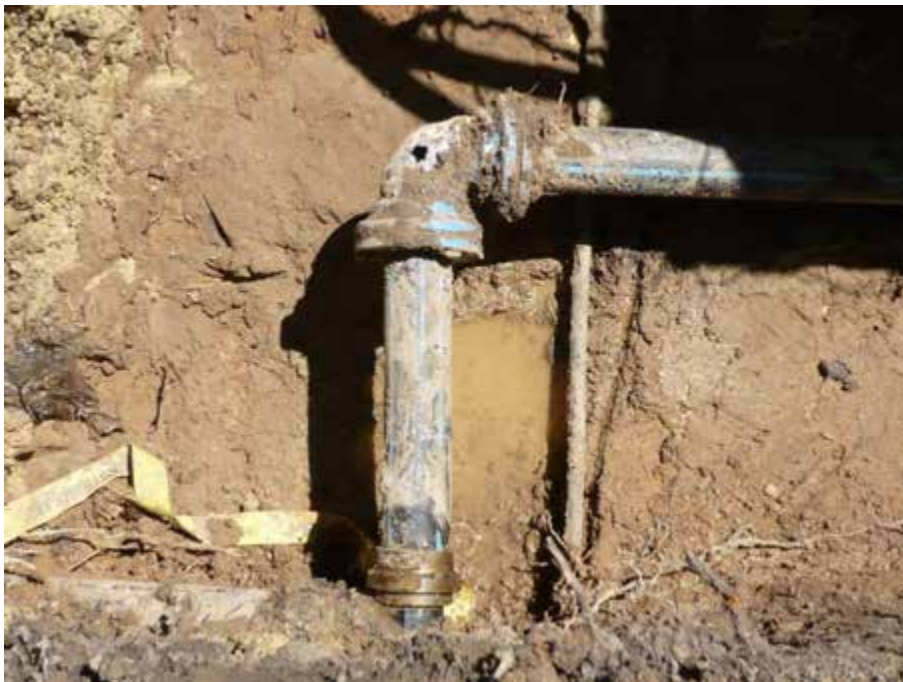
Abbildung 17: Loch in der ca. 1 m tief liegenden Hauptleitung vom Hochbehälter zum Technikzentrum. Ursache ungeklärt.
