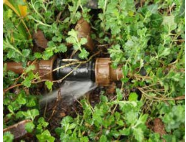
Abbildung 21: Undichte Schraubverbindung beim Tropfrohr im Zedernhain (Parzelle 2).
