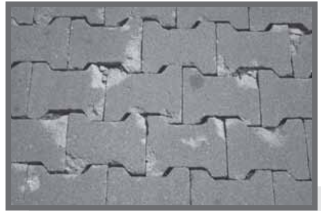
Bild 1: Fugenlos verlegtes Verbundpflaster, unter Verkehrsbelastung gebrochen.
