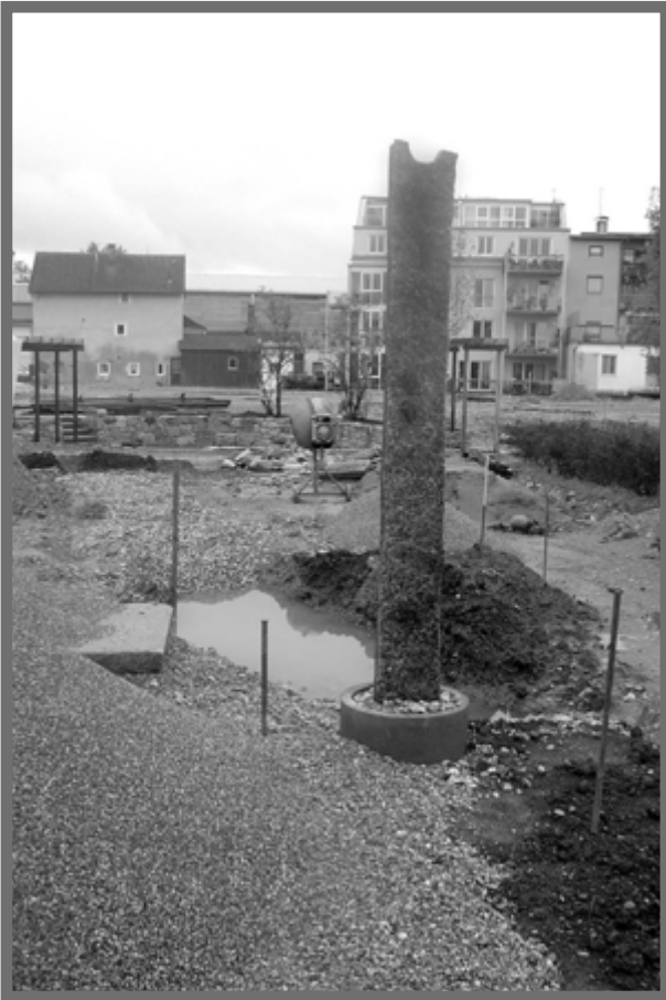
Bild 1: Das Hochwasser im Frühjahr 2009 behinderte die Bauausführung.
