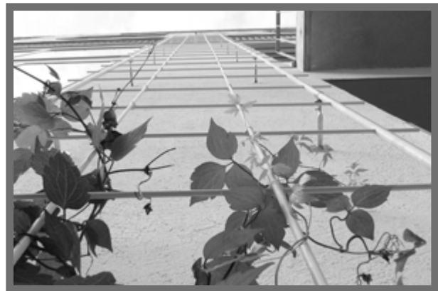
Bild 3: Kletterhilfen aus GFK, Hohes Gitterelement.
