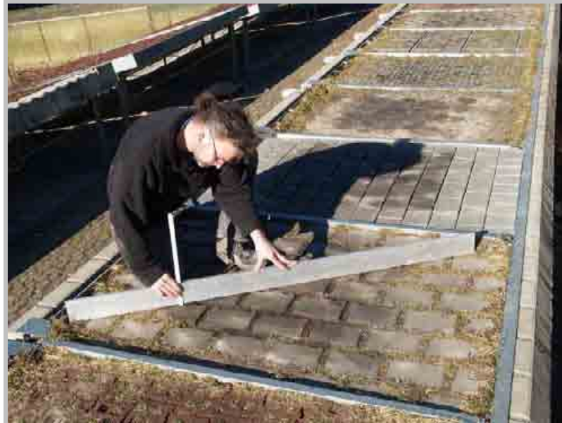
3 Jahre Parknutzung mit 3 Abstellvorgängen täglich und Schadstoffeinträgen in Form von Öl und Schwermetallen gehen an den Flächenbefestigungen zumindest optisch nicht spurlos vorbei
