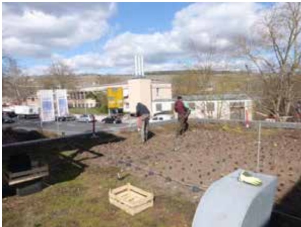
Bild 29: Auslegen der Stauden-Bepflanzung beim Rückbau auf dem Dach der LGA im Jahr 2019
