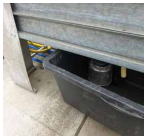
Bild 8: Behälter und Pumpe unter Dachmodell
