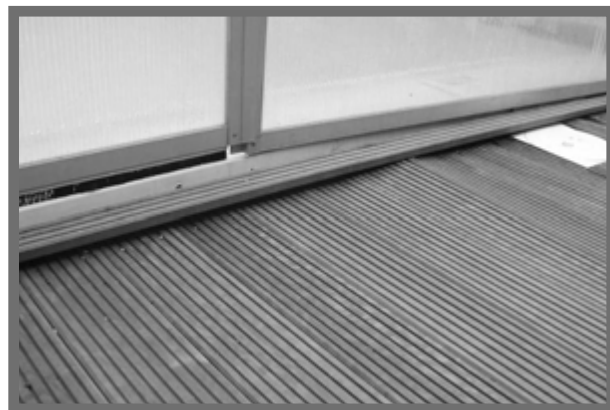
Bild 1: Nichtbeachtung der Holzfeuchte bei der Konstruktion kann zum „Aufstellen“ der Holzdielen führen. Reklamationen sind dann vorprogrammiert.
