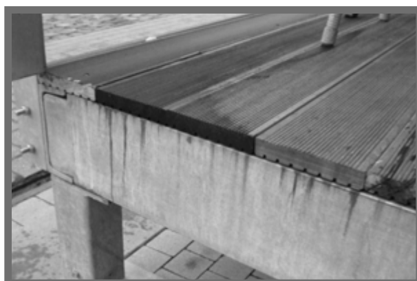
Bild 5: Holzinhaltstoffe (hier von Bangkirai) sind ausgeblutet und haben zu einer Verfärbung geführt.
