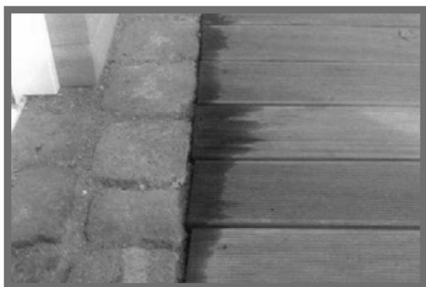
Bild 4: Die Wachsschicht (Paraffin), die zur Versiegelung auf die Stirnseite von Harthölzern aufgebracht wird, ist hier nicht abgeschnitten worden und in der Folge ausgelaufen.
