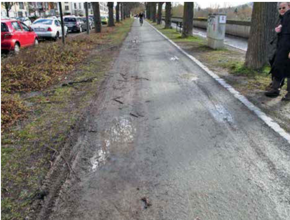
Bild 5: Keine Überraschung: Alle wasser gebundenen Decken sind auf Dauer mit dem Radverkehr überfordert. In der Würzburger Teststrecke wurden sie im Frühjahr 2014 durch Pflaster und Asphaltbauweisen ersetzt.
