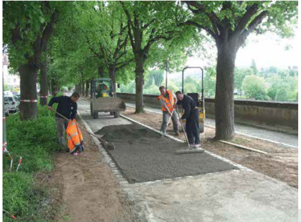
Bild 2: Die Herstellung der Flächenbefestigungen (hier: „Perma-Zyme 11 x“) erfolgte ausschließlich durch die Hersteller oder autorisierte Lizenznehmer.
